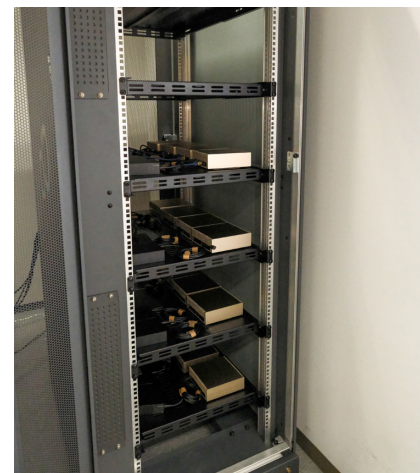
1つの棚にまとめて設置されている小型AIスーパーコンピューター「NVIDIA DGX Spark」
