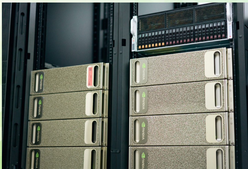
NVIDIA Omniverse 環境を支える GPU・レンダリングサーバー
